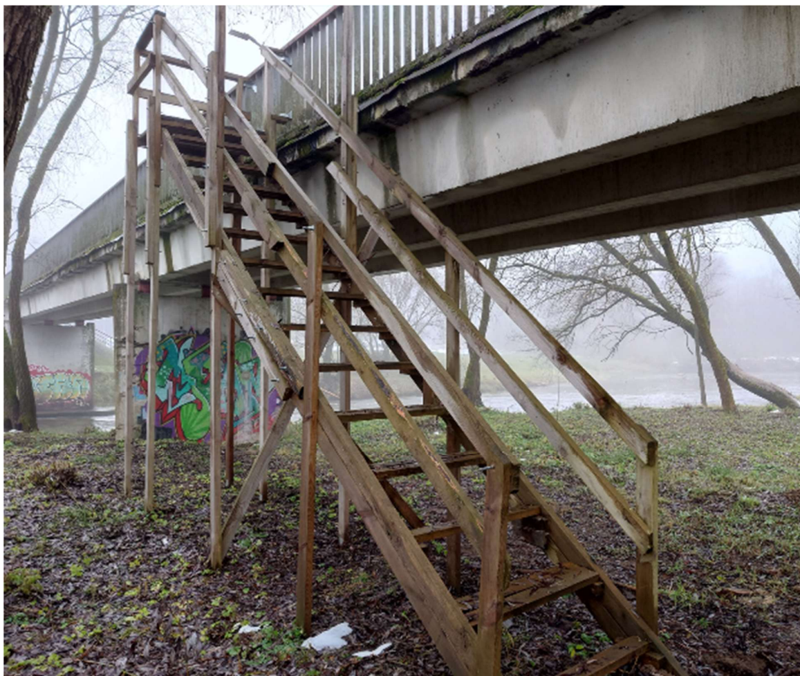
8 pav. Nesaugūs esami techniniai laiptai.
