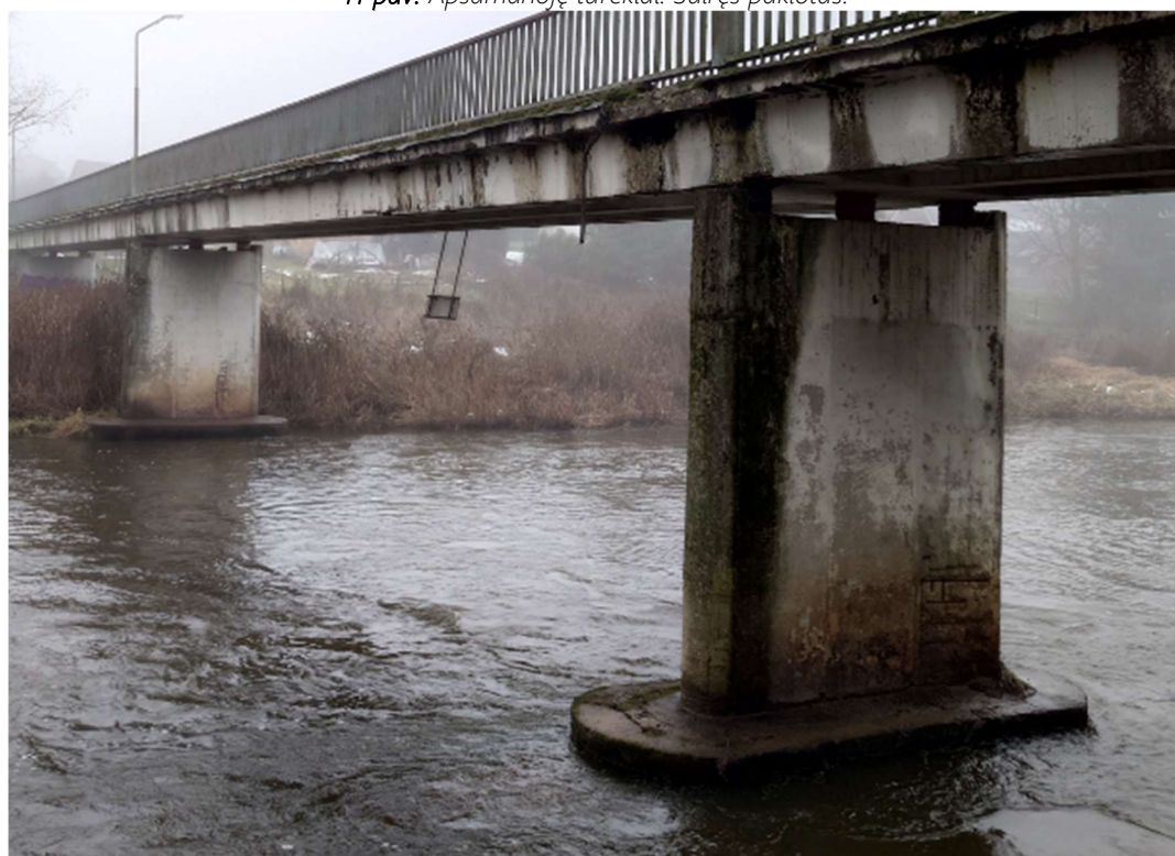
12 pav. Tarpinės atramos neapsaugotos nuo paplovimo
