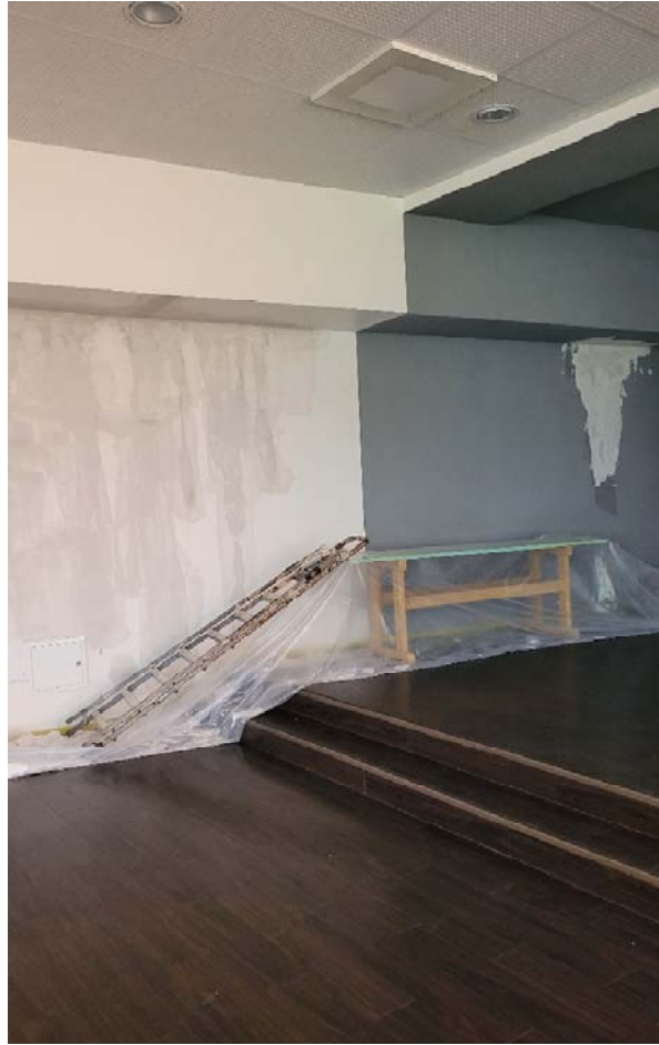
8 pav. Salės siena prieš remontą
